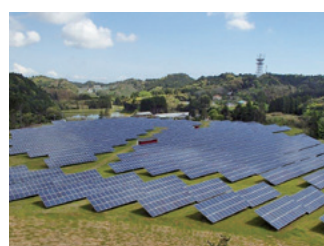
勝浦太陽光発電所
