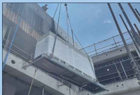
空調機 室外機ユニット
