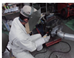
アーク溶接機 18台 口径：25A~400A
