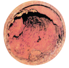
配管後8年経過した 白ガス管
