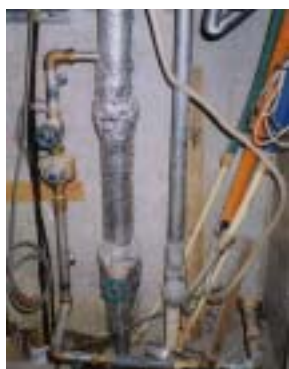
メーター廻り施工例
